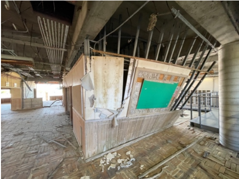
一樓出入口的教室破壞情形
