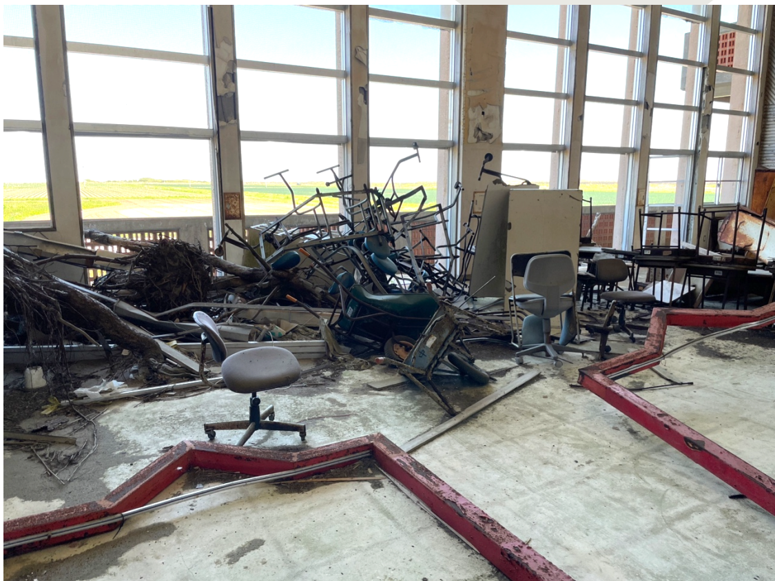
一樓紅色矮牆支架倒塌與食堂毀壞現場
